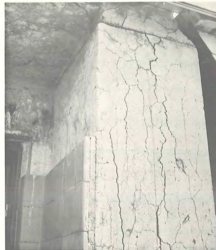
Fig.6. Netrevner ("map cracking") fremkaldt af, at dannelsen af alkali-kiselgel forårsager ekspansioner i betonen (52 N 1).
